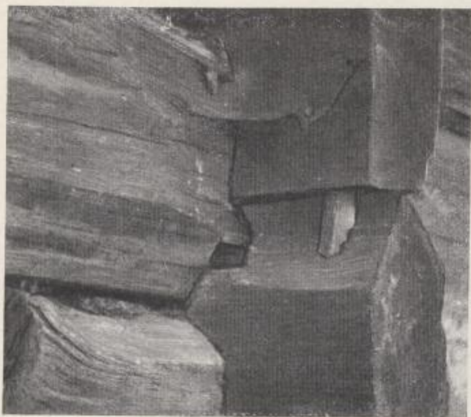
Bild 157: Verdübelung der Wettköpfe in Burg / Spreewald Nr. 222
